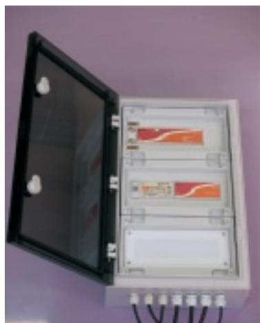
Rys. 2. Rozdzielnia ze sterownikami Fig. 2. Switching table with drivers
